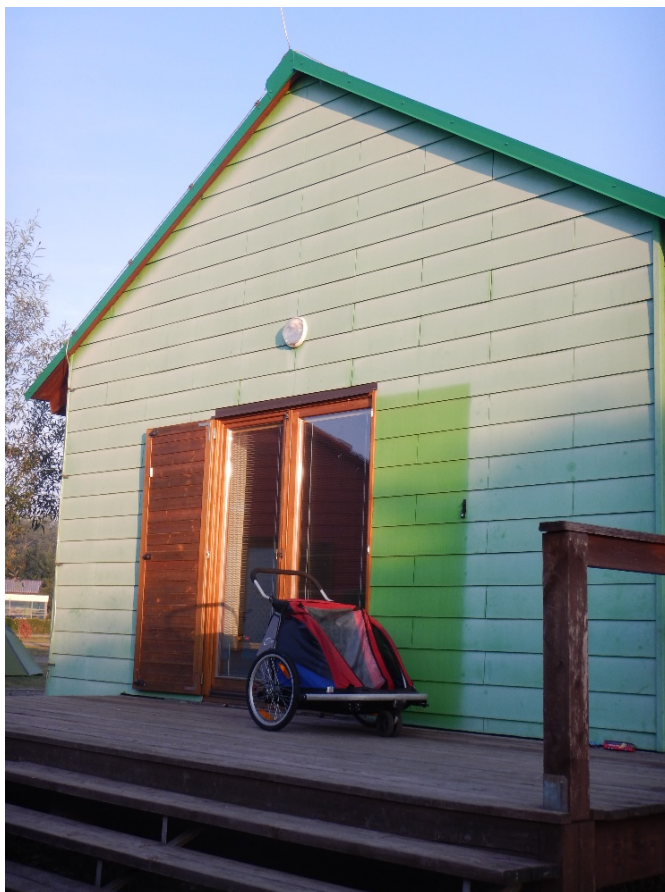
Obr. 1: Degradace barevného odstínu – na opláštění z překládaných cementotřískových desek přetíraných na stavbě je dobře patrná totální degradace barevného odstínu v porovnání s částí opláštění, která byla dlouhodobě chráněna před slunečním svitem
