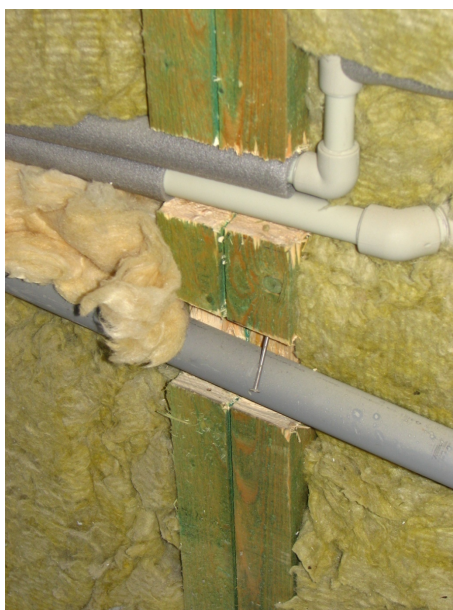
Obr. 2: Oslabení průřezu sloupku nosné stěny ze strany koupelny
