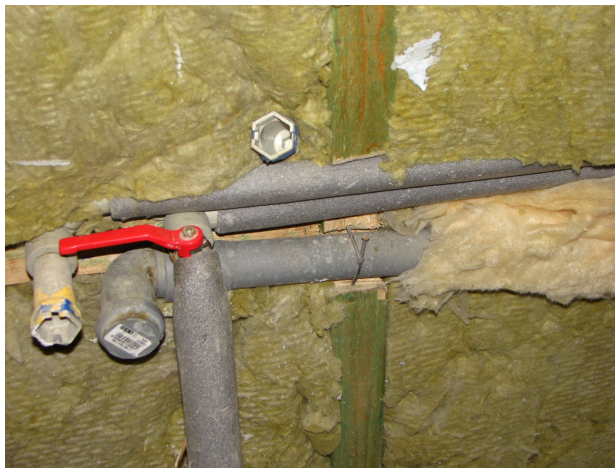
Obr. 1: Oslabení průřezu sloupku nosné stěny ze strany kuchyně
