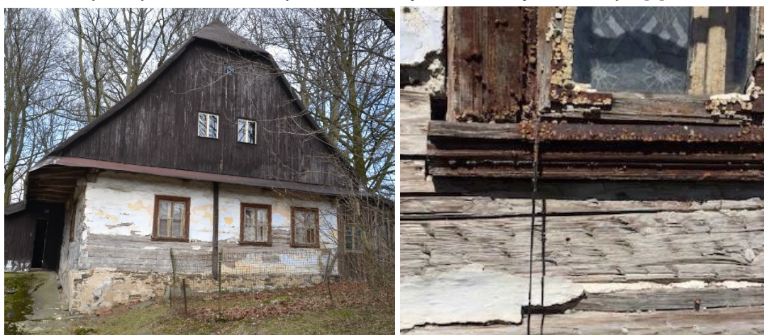
Obr. 7: Pohled na jižní roubenou stěnu a detail poškození okna (fotoarchiv Čechová)
