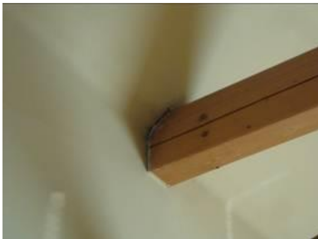
Obr. 8: Detail praskání sádkokartonu vlivem pohybu nosných trámů
