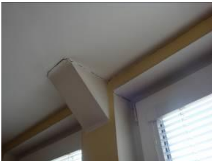
Obr. 11: Detail chybně řešeného trámu obaleného sádkartonem bez možnosti dilatace
