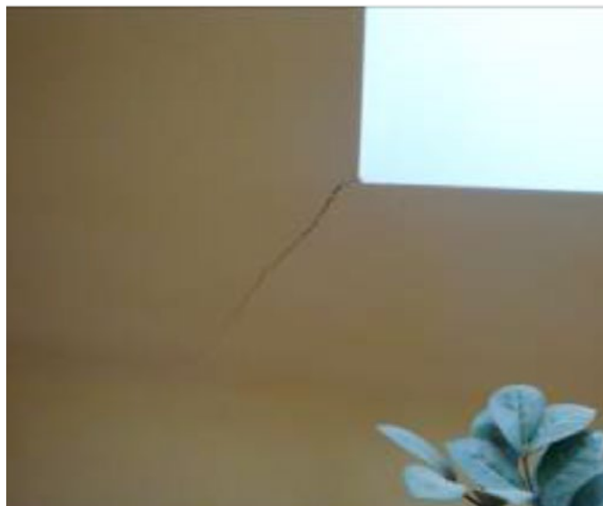
Obr. 10: Detail porušení sádkokartonu v ostění střešních oken
