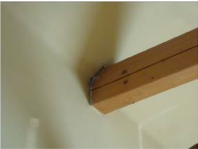
Obr. 8: Detail praskání sádrokartonu vlivem pohybu nosných trámů
