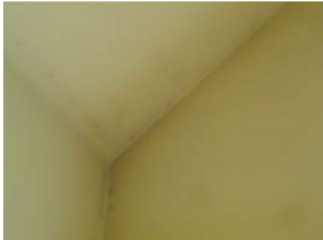
Obr. 9: Kondenzace vodní páry s výskytem plísní na vnitřním povrchu v chladném koutu vlivem tepelných mostů
