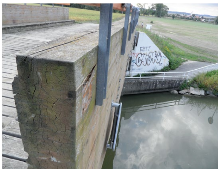
Obr. 23: Zanedbaná údržba – výsušné trhliny lepeného nosníku
