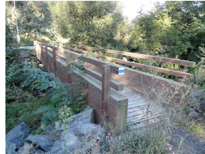
Obr. 33: Okolí mostu neumožňuje vysušení dřeva proudem vzduchu
